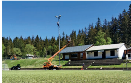
Die Umrüstung von Lumosa bei einem 1-zu-1-Austausch. Foto: Lumosa
